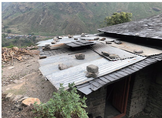
トタンで応急処置をした食堂棟の厨房の屋根
